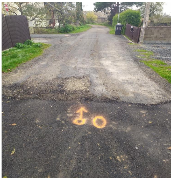
Místní komunikace před opravou
